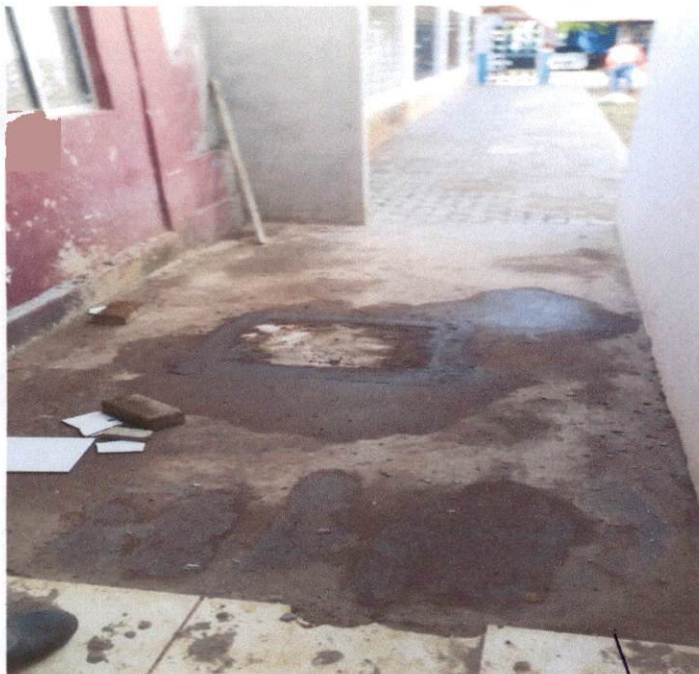
Item: 10.1 PISO CIMENTADO TRAÇO 1:3(CIMENTO E AREIA) ACABAMENTO RUSTICO CENTRO DE DESENVOLVIMENTO
