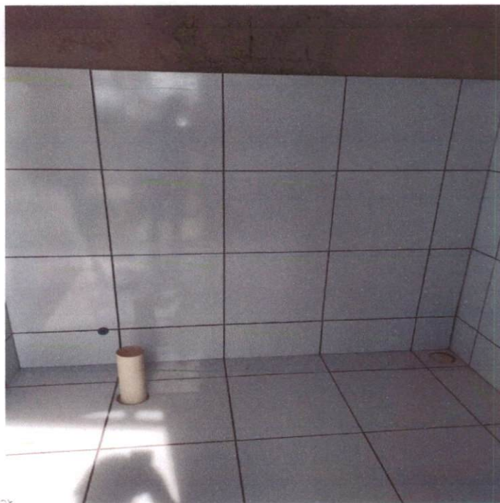
Item: 8.7 PONTO DE CONSUMO TERMINAL DE ÁGUA FRIA (SUBRAMAL) COM TUBULAÇÃO DE PVC, DN 25 MM 8.8 PONTO DE ESGOTO COM TUBO DE PVC RIGIDO DE 40MM ESCOLA ANTONIO MONTENEGRO
