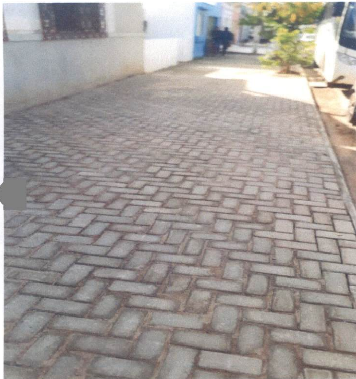
Item: 10.5 EXECUÇÃO DE PASSEIO EM PISO INTERTRAVADO COM BLOCO RETANGULAR COR NATURAL CENTRO DE DESENVOLVIMENTO
