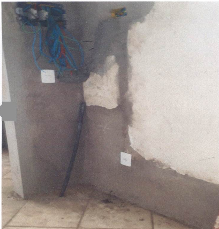
Item: 9.17 PONTO DE TOMADA RESIDENCIAL INCLUINDO TOMADA 10ª 250V CENTRO DE DESENVOLVIMENTO
