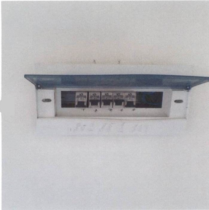
Item: 9.21 DISJUNTOR MONOPOLAR TIPO DIN CORRENTE NOMINAL DE 16A CENTRO DE DESENVOLVIMENTO
