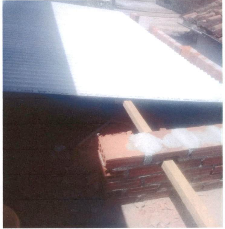
Item: 7.9 TELHAMENTO COM TELHA DE FIBRACIMENTO ONDULADA ESP=4MM 7.10 TRAMA DE MADEIRA COMPOSTA POR TERÇAS PARA TELHADOS DE ATE 2 ÁGUAS CENTRO DE DESENVOLVIMENTO
