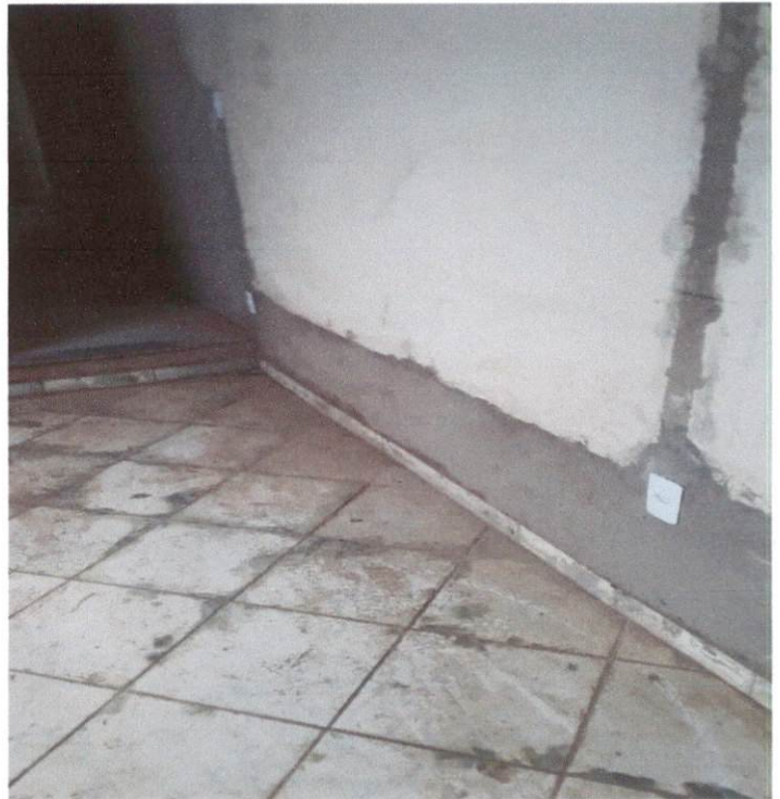
Item: 9.17 PONTO DE TOMADA RESIDENCIAL INCLUINDO TOMADA 10ª 250V CENTRO DE DESENVOLVIMENTO
