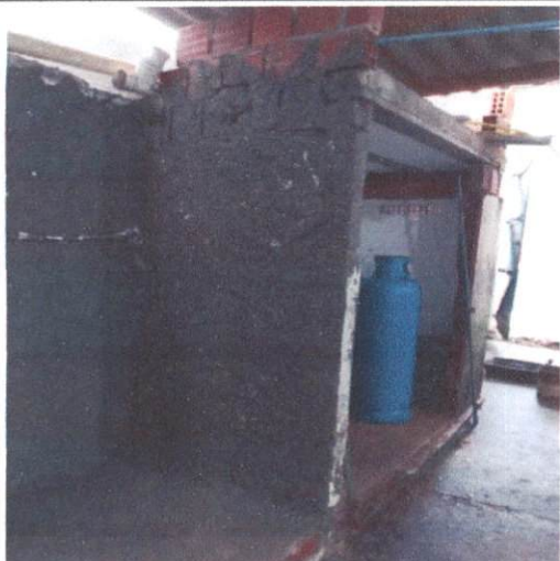
Item: 3.2.4 CHAPISCO APLICADO EM ALVENARIAS E ESTRUTURAS DE CONCRETO INTERNAS, COM COLHER DE PEDREIRO. ARGAMASSA TRAÇO 1:3 COM PREPARO MANUAL. AF_06/20 14
