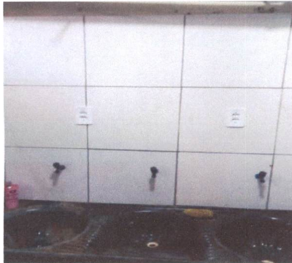
Item: 3.3.1 PONTO DE TOMADA RESIDENCIAL INCLUINDO TOMADA (2 MÓDULOS) 10A/250V, CAIXA ELÉTRICA, ELETRODUTO, CABO, RASGO, QUEBRA E CHUMBAMENTO. AF_01/201
