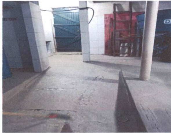
Ítem: 3.2.2 PINTURA DE PISO COM TINTA ACRILICA, APLICAÇÃO MANUAL, 2 DEMÃOS, INCLUSO FUNDO PREPARADOR AF_05/2021
