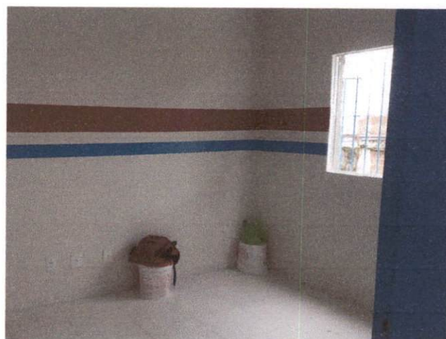
Foto 14: Aplicação de pintura interna, inclusive faixa com tinta acrílica e pintura das esquadrias com tinta a óleo. Comprova os Itens 6.1, 6.3, 6.4, 6.5 e 6.6
