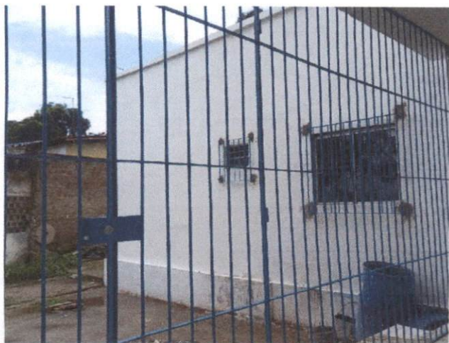
Foto 3: Fornecimento e assentamento de gradil e/ou portão, inclusive aparelhamento e pintura. Comprova o item 5.2.
