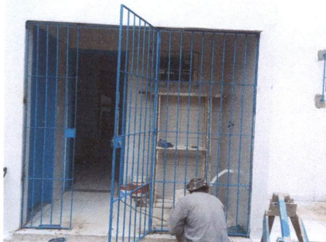
Foto 5: Fornecimento e assentamento de gradil e/ou portão, inclusive aparelhamento e pintura. Comprova o item 5.2.
