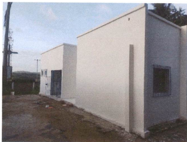
Foto 17: Aplicação de pintura externa e interna, inclusive faixa com tinta acrílica e pintura das esquadrias com tinta a óleo. Comprova os Itens 6.1, 6.3, 6.4, 6.5 e 6.6
