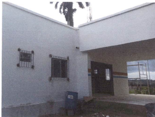
Foto 9: Aplicação de pintura externa e interna, inclusive faixa com tinta acrílica e pintura das esquadrias com tinta a óleo. Comprova os Itens 6.1, 6.3, 6.4, 6.5 e 6.6.
