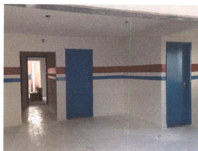
Foto 16: Aplicação de pintura interna, inclusive faixa com tinta acrílica e pintura das esquadrias com tinta a óleo. Comprova os Itens 6.1, 6.3, 6.4, 6.5 e 6.6
