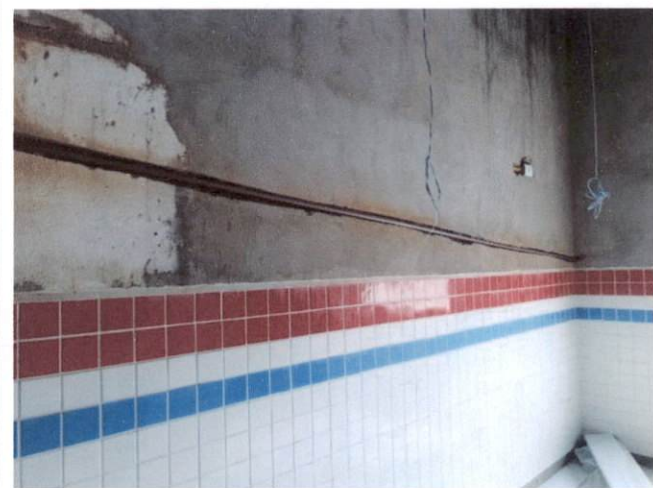
Foto 36: Tubulação para dreno do ar-condicionado. (Item 12.2.3)
