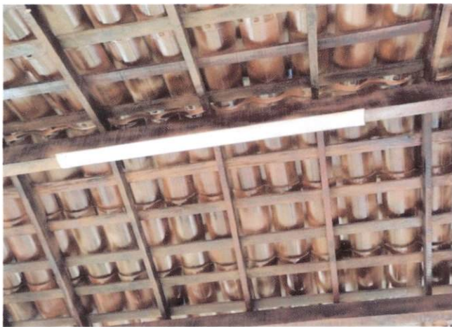
Foto 29: Ponto de luz em teto, incluindo luminária tipo calha, de sobrepor, de LED 36 W. (Itens 10.1 e 10.5)
