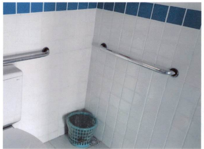
Foto 28: Barra de apoio em aço inox. (Item 9.6)
