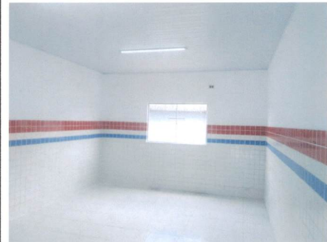
Foto 12: Aplicação manual de pintura em paredes, duas demãos, incluindo aplicação e lixamento de massa látex em paredes, duas demãos. (Item 8.1 e 8.2)
