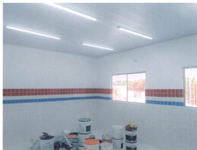
Foto 14: Aplicação manual de pintura em paredes, duas demãos, incluindo aplicação e lixamento de massa látex em paredes, duas demãos. (Item 8.1 e 8.2)
