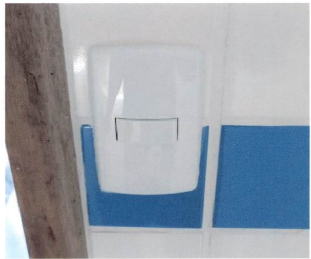
Foto 30: Ponto de interruptor de 1 seção. (Item 10.3)
