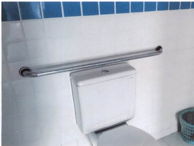
Foto 27: Barra de apoio em aço inox. (Item 9.6)
