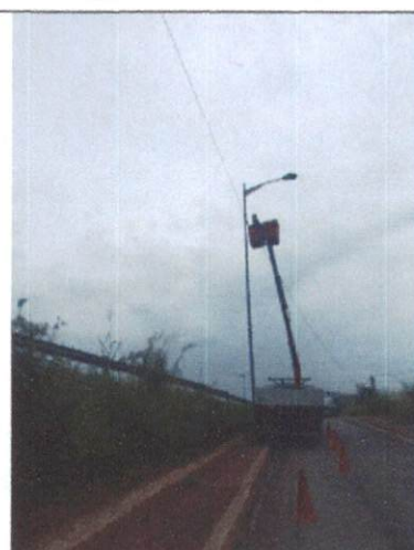
Foto 51: Extensão de rede IP e instalação de luminária LED na BR-408, próximo ao Bar da Tripa.
