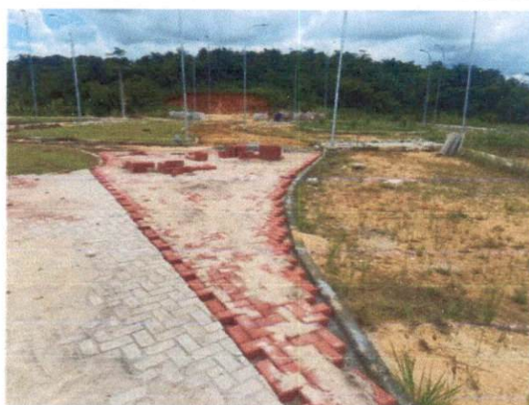
Item: 1.3.1 - EXECUÇÃO DE PÁTIO/ESTACIONAMENTO EM PISO INTERTRAVADO, COM BLOCO RETANGULAR COLORIDO DE 20 X 10 CM, ESPESSURA 8 CM. AF_12/2015
