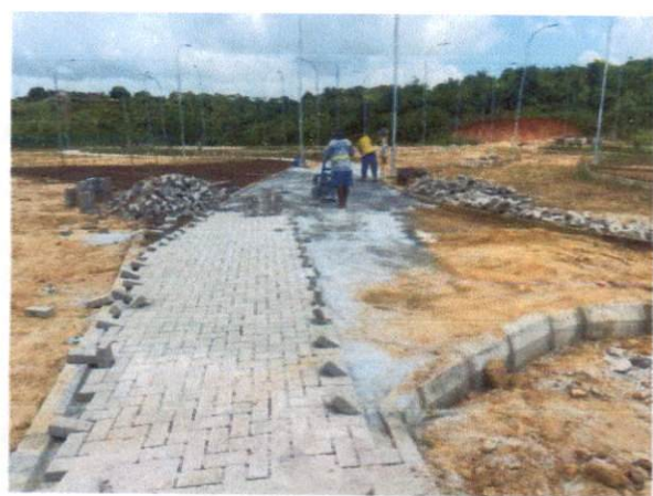
Item: 1.3.2 - EXECUÇÃO DE PÁTIO/ESTACIONAMENTO EM PISO INTERTRAVADO, COM BLOCO RETANGULAR COR NATURAL DE 20 X 10 CM, ESPESSURA 8 CM. AF_12/2015
