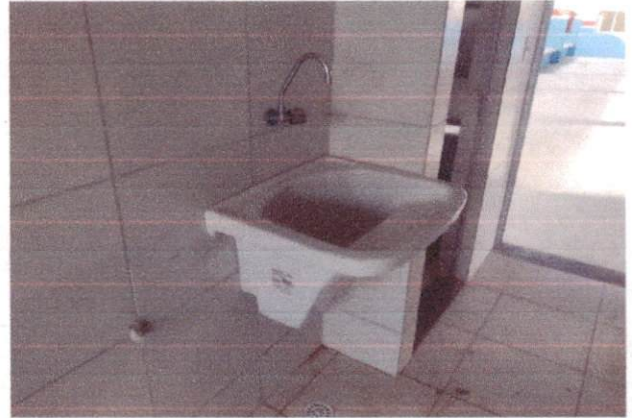
14.14 Tanque Grande 40L cor branco gelo, incluso torneira de metal cromado, Deca ou equivalente
